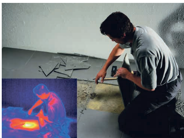
3 | ... schadhafte Leitungen lokalisieren und damit Reparaturarbeiten eingrenzen ...
