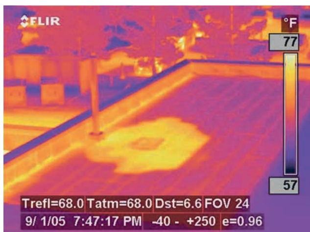
2 | Die passive oder aktive Bauthermografie kann Wasser-schäden an Flach- oder Steildächern erkennen ...
