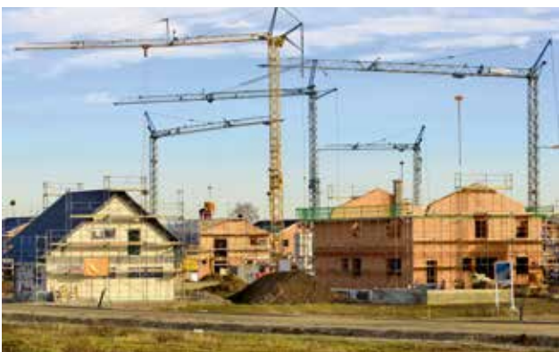
3 | Werden Maschinen und Kräne fälschlicherweise auf dem Grundstück eines Nachbarn aufgestellt, so kann der Bauleiter direkt gegenüber einem Nachbar haften.
