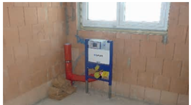
3 | Leider oft Realität: Kein Glattstrich hinter einem Spülkasten an der Außenwand.
