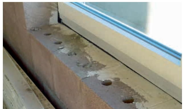
5 | Negativbeispiel: Fensterbrüstung nicht geschlossen.
