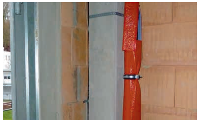
4 | Negativbeispiel: Kein Glattstrich bei Rohr- und Schachtführungen an Außenwänden / Kaminsteinen
