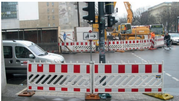
2 | Kann der gegenüberliegende Gehweg nicht betreten werden, muss eine Abschränkung das Queren von Fußgängern verhindern.
